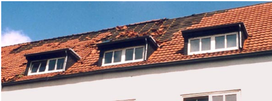
Sturmschaden Sogbereich Satteldach Foto: Krolkiewicz
